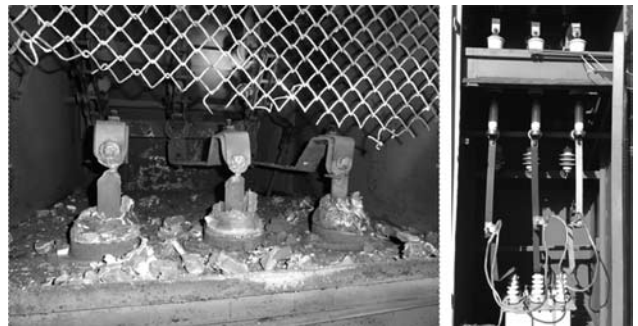
Рис. 1. Повреждение проходных изоляторов в ячейке КРУ: а — повреждение проходных изоляторов; б — ячейка с ОПН
